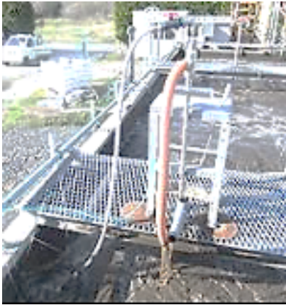
図 13. S 農場の曝気槽に設置した MLSS モニタの外観
